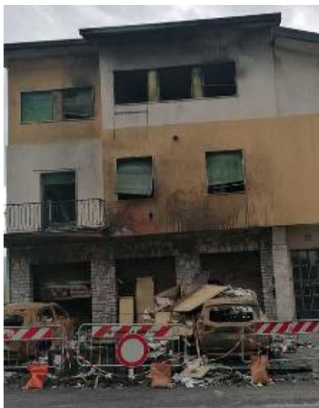
La foto mostra i danni dell'esplosione
