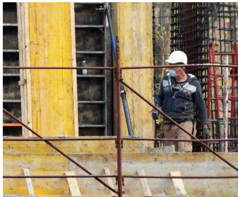
Il casco di protezione obbligatorio (e necessario) per la sicurezza nei cantieri edili
